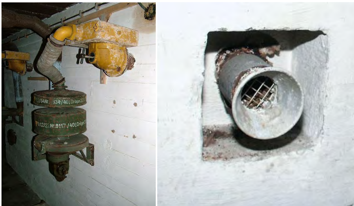
Оборудование немецких батарей: фильтро-вентиляционная установка
